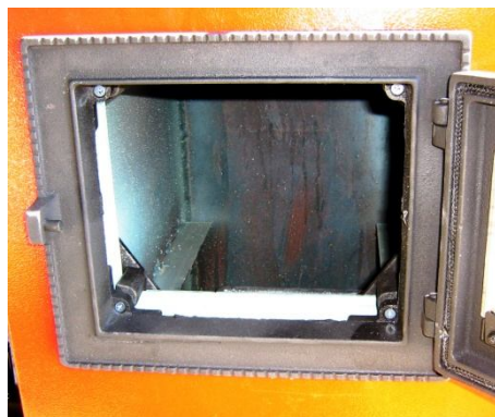
Рисунок 5 – Топочная дверка котла
